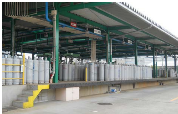
高圧ガス施設
