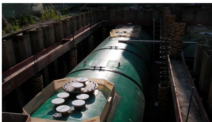
地下貯蔵タンク
