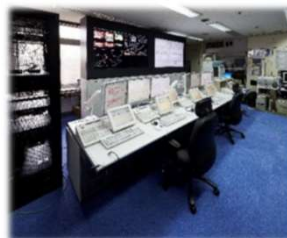
高機能消防指令センター
