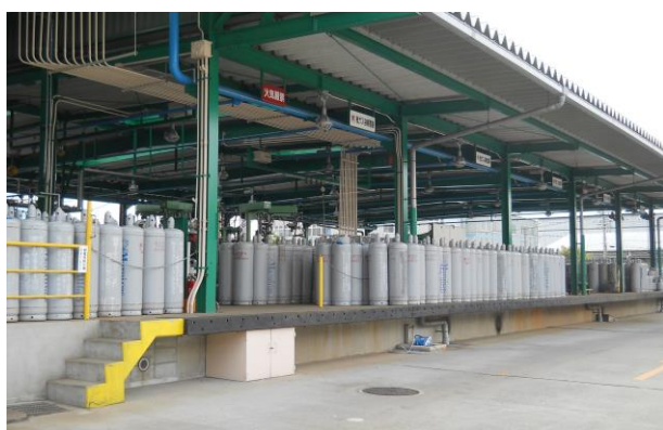
高圧ガス施設
