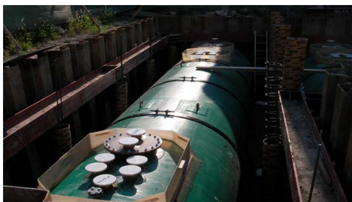
地下貯蔵タンク
