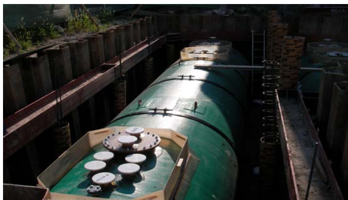
地下貯蔵タンク
