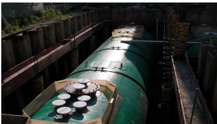
地下貯蔵タンク
