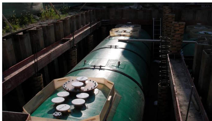
地下貯蔵タンク
