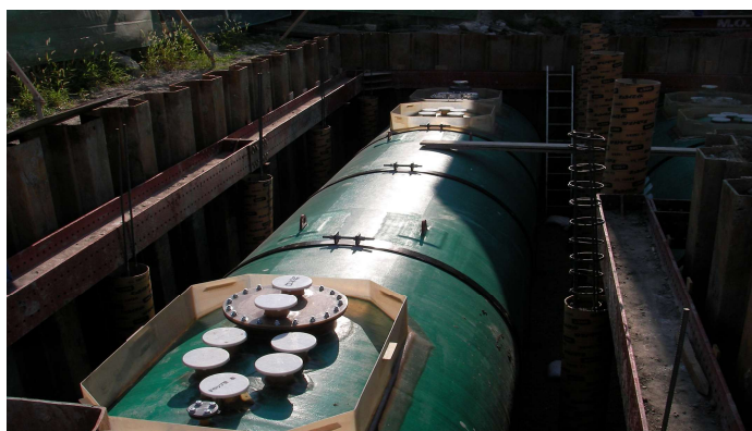
地下貯蔵タンク
