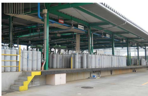
高圧ガス施設
